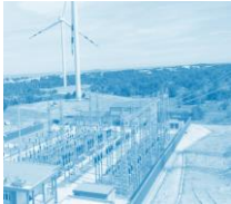
80 MW Mui Ne Wind
